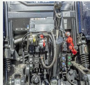
Fließrichtung und Nummer der Ventile zeigt nur der Aufkleber!
